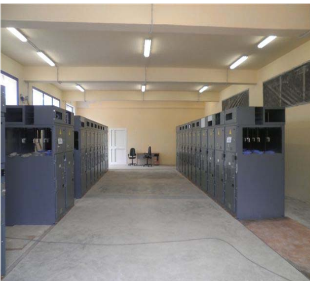
Figure 3: CT1 bis MV Switchboard
