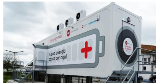
Figure 1 – EDP Distribuição Energy Storage System
